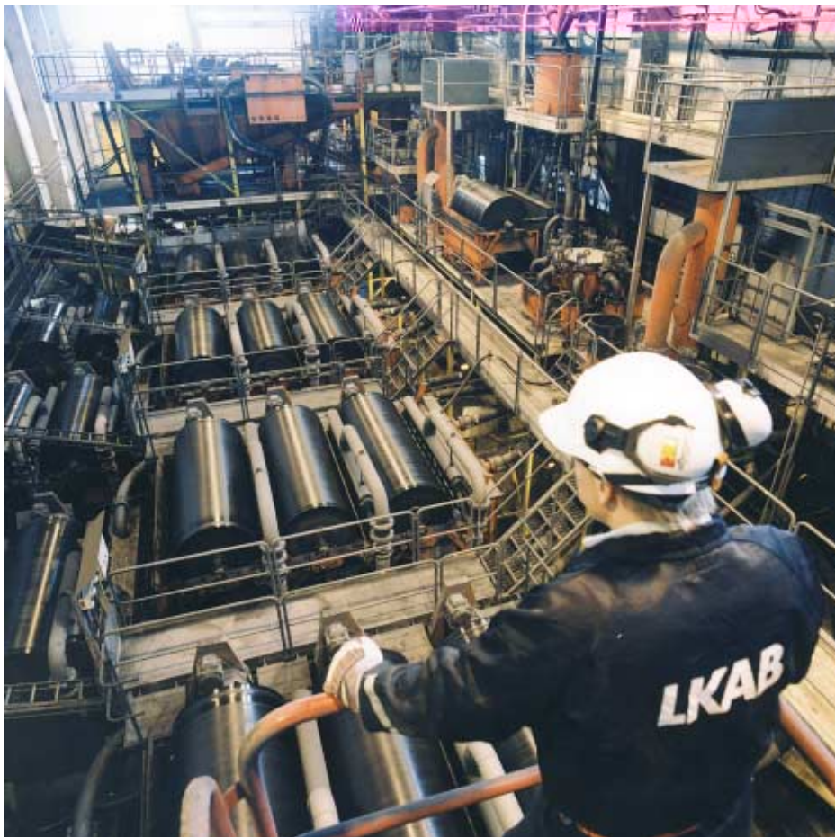
Magnetseparatorer i ett av pelletsverken i Kiruna.
