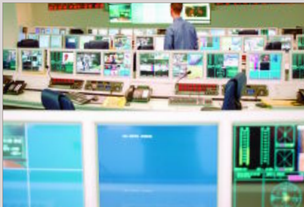
Le réseau-coeur des transmissions à Londres permet des routages divers pour assurer la résilience des connexions.
