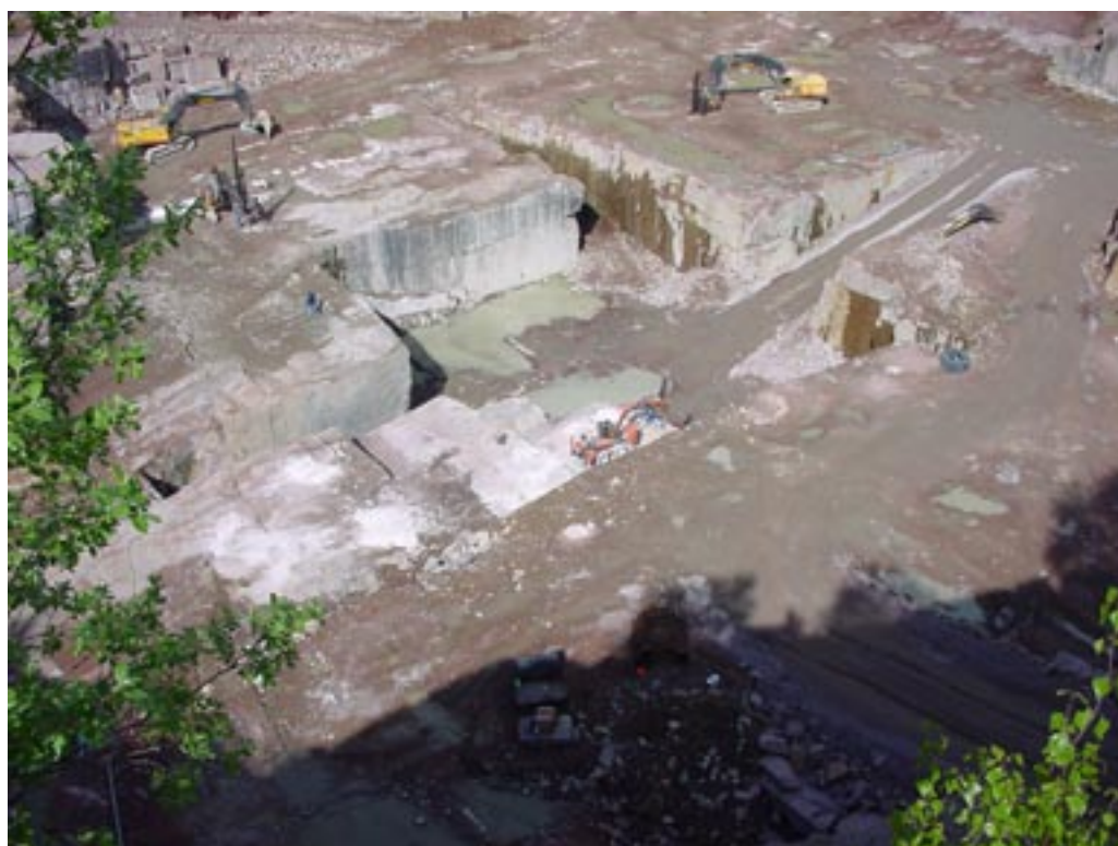
Emmaboda Granits naturstenstäkt i Vånga, Kristianstads kommun, Skåne län. Foto: Emmaboda Granit AB.
