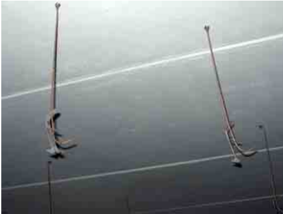
Kuva 5. Kylpylän alakaton romahtaminen Kuopiossa 4.9.2003. Kannatinrangasta irronneita ripustimia, joiden korvakkeet ovat taipuneet.
