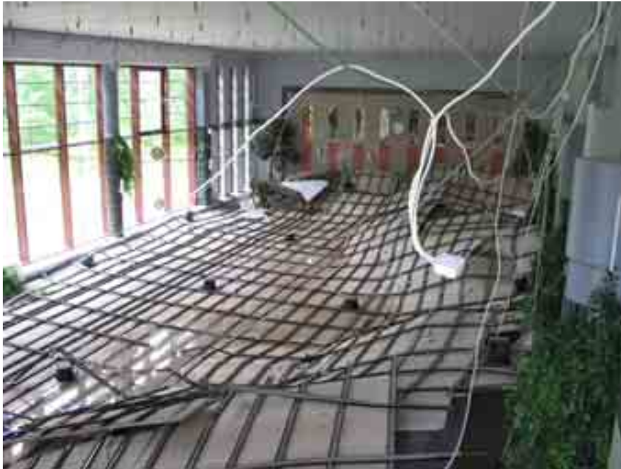
Kuva 1. Kylpylän alakaton romahtaminen Kuopiossa 4.9.2003. Alas tullut katto vesiliukumäkikulmasta kuvattuna. Miesuimari pääsi pois altaasta vasemmalla takana olevasta kulmasta ja nainen keskeltä oikealta.
