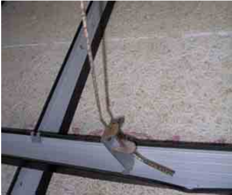
Kuva 3. Kylpylän alakaton romahtaminen Kuopiossa 4.9.2003. Katkennut ripustinlanka, jonka jousiripustin on kiinni kannatinrangassa.
