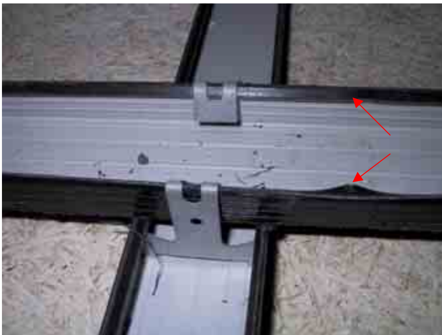
Kuva 4. Kylpylän alakaton romahtaminen Kuopiossa 4.9.2003. Jousiripustin on irronnut kannatinrangasta ja kannatinrangan kanttaus on pettänyt nuolten osoittamista kohdista. Kuvan keskellä rankojen lukituskappaleet.
