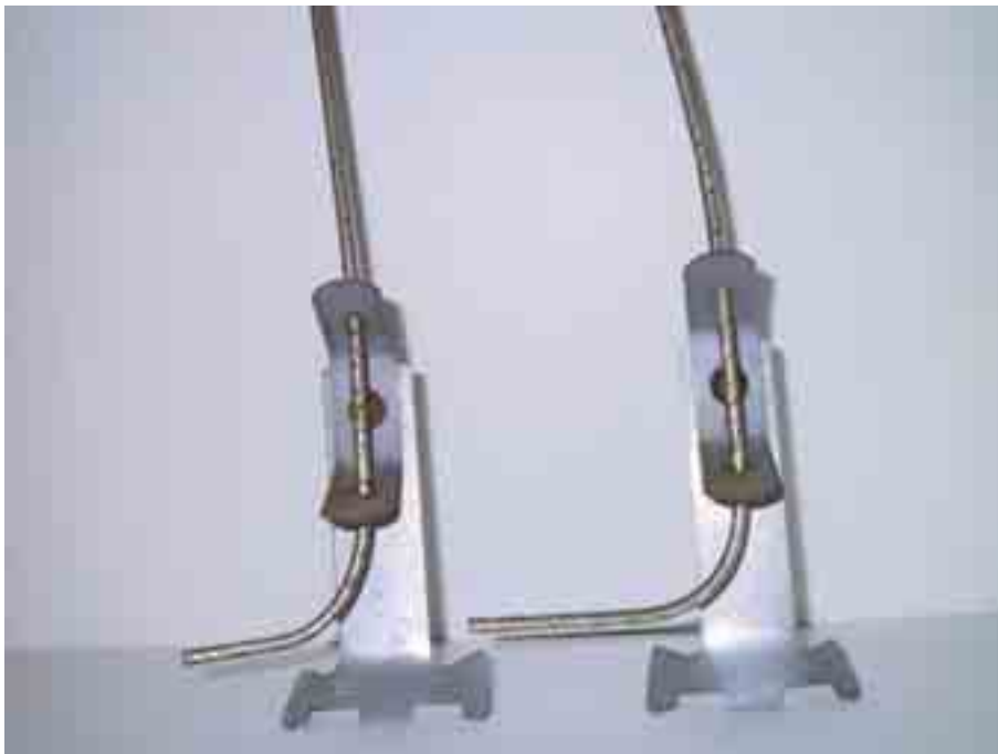
Kuva 6. Kylpylän alakaton romahtaminen Kuopiossa 4.9.2003. Ripustinlankoja oli kahta eri tyyppiä. Oikeanpuoleisessa langassa on koneellisessa oikaisussa syntynyt lankaa kiertävä matala ura. Kummassakin langassa on merkkejä korroosiosta.
