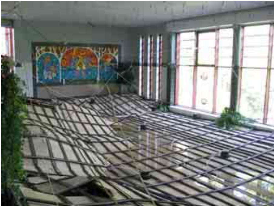
Kuva 2. Kylpylän alakaton romahtaminen Kuopiossa 4.9.2003. Alas tullut katto toisesta päästä kuvattuna. Naisuimari avustettiin pois altaasta keskellä kuvaa näkyvästä kulmasta.
