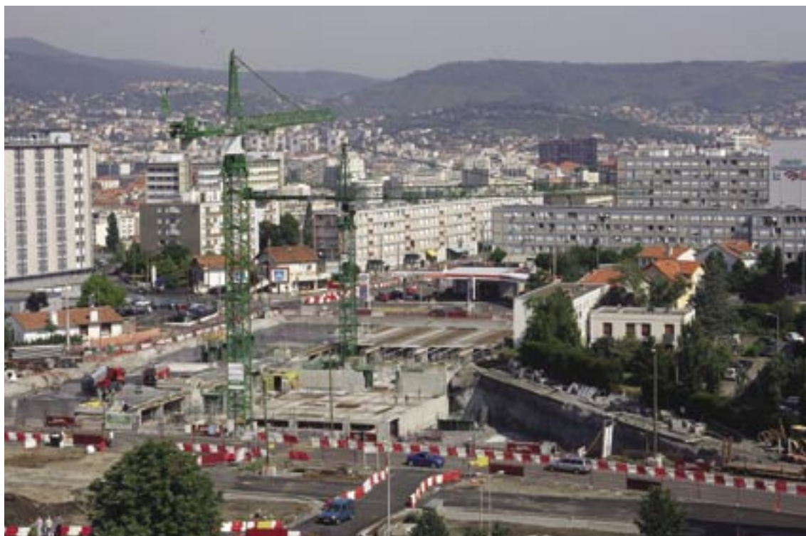
Fin juin : la plate-forme du tramway est prête pour la pose des rails.
