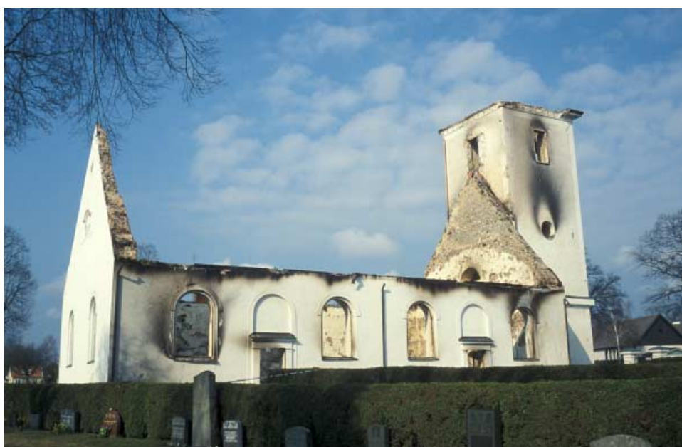
Ryssby kyrka efter branden våren 2001. Församlingen har diskuterat alternativa lösningar till en återuppbyggnad. Den allmänna viljan är dock att kyrkan ska återuppföras och arbetet med återuppbyggnaden har påbörjats. Kyrkans exteriör kommer att återställas. Foto: Kerstin Alexandersson.
