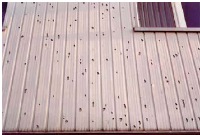
Abbildung 3: Hagelschaden an Kunststofffassade, Wetzikon 2004. (Quelle: Thomas Egli)
