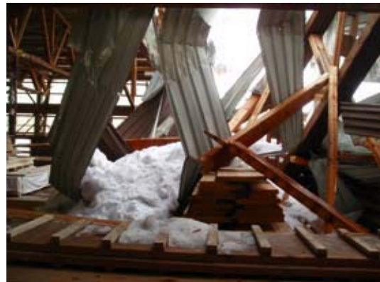
Abbildung 4: Schneedruck verursacht Hallendacheinsturz, Waldstatt 2006. (Quelle: Thomas Egli)
