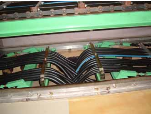
燃料交換機給電ボックス
