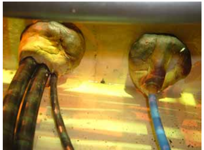
ケーブル貫通部
