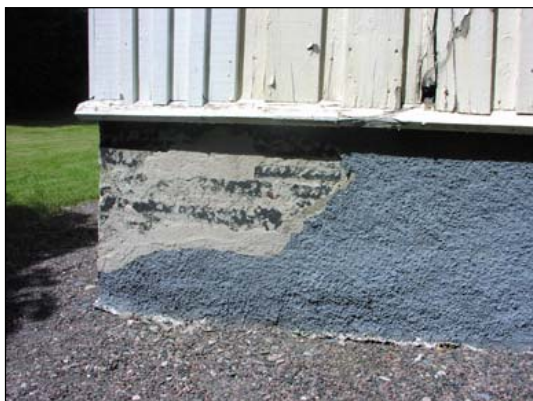
Skador i den putsade sockeln.
