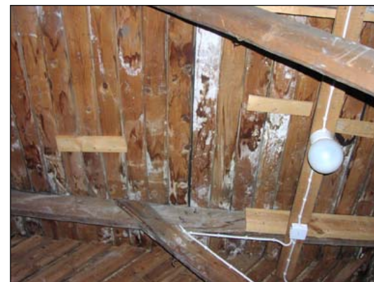
Gamla vattenskador i undertaket på en av vindarna.
