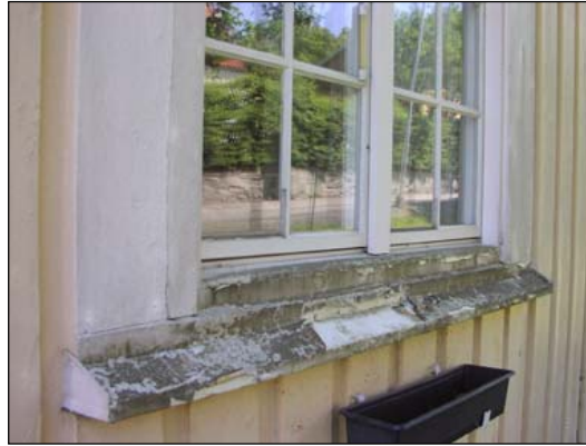
Färg flagnar på fönsterbleck.
