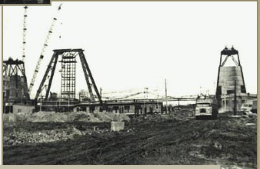
Głębienie szybów nr I i II przy pomocy wieży i urządzeń tymczasowych oraz fragment scalania wieży szybu I na miejscu zastępczym
