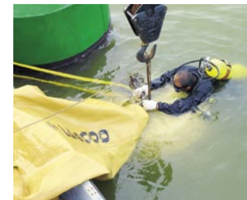
La ubicación de la boya del Canal de Turbo requirió una bolsa de reflote.
