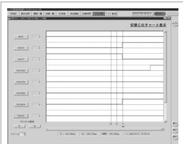
図6. 切替開閉器動作チャートの表示画面(C-SCADA) - 列車位置情報により切替開閉器の開閉を実施しているが、そのタイムチャートを記録、表示する。
