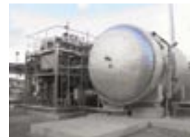
300kW level MCFC
