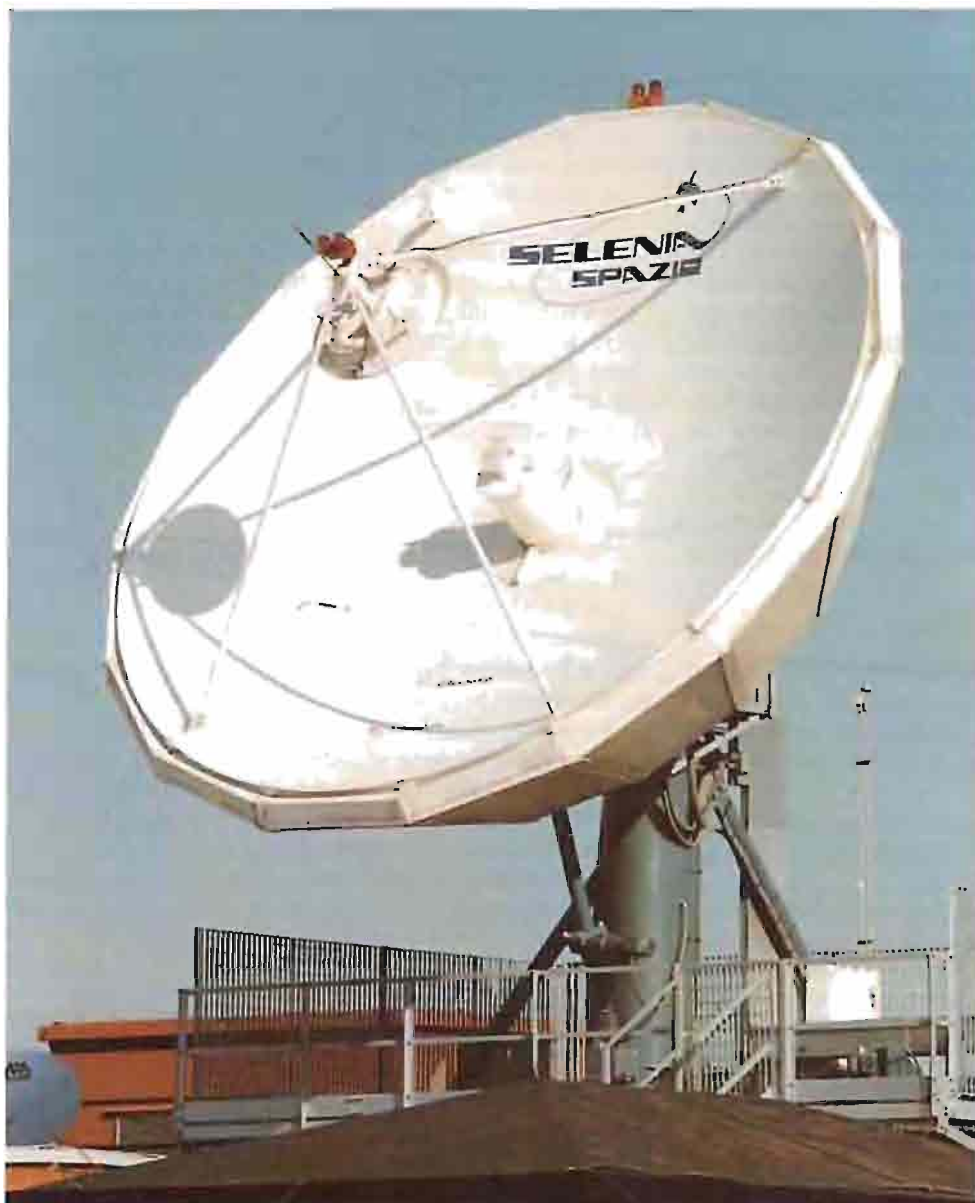
Stazione trasmittente fissa di Telespazio puntata verso il satellite Olympus e posta sull'edificio del Centro di Produzione TV della RAI a Roma. L'antenna ha un diametro di 6,1 metri, con illuminatore tipo Cassegrain, ed è munita di sistema automatico di puntamento del satellite. La stazione, trasmittente nella banda di frequenze di 17 GHz, ha inoltre capacità di ricezione monitoria nella banda a 12 GHz. La stazione è stata costruita dalla Società SELENIA SPAZIO.
