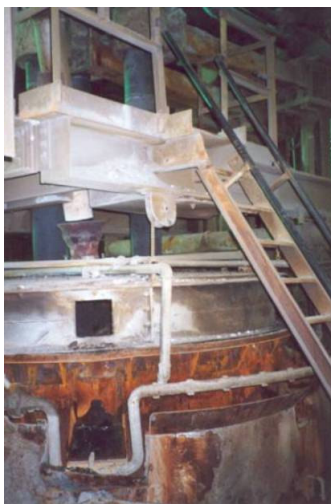
Figura 10 - Forno elétrico para a fabricação de fluxos fundidos
