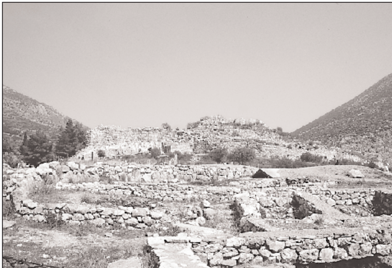
Η ακρόπολη των Μυκηνών και ο ταφικός κύκλος Β'. Οι αναστηλωτικές εργασίες, όπως και οι εργασίες διαμόρφωσης του ευρύτερου αρχαιολογικού χώρου βρίσκονται σε εξέλιξη. Το ολοκληρωμένο πρόγραμμα προστασίας και ανάδειξης των Μυκηνών θα συμβάλει αποφασιστικά στη σωτηρία του μοναδικού μνημείου.
