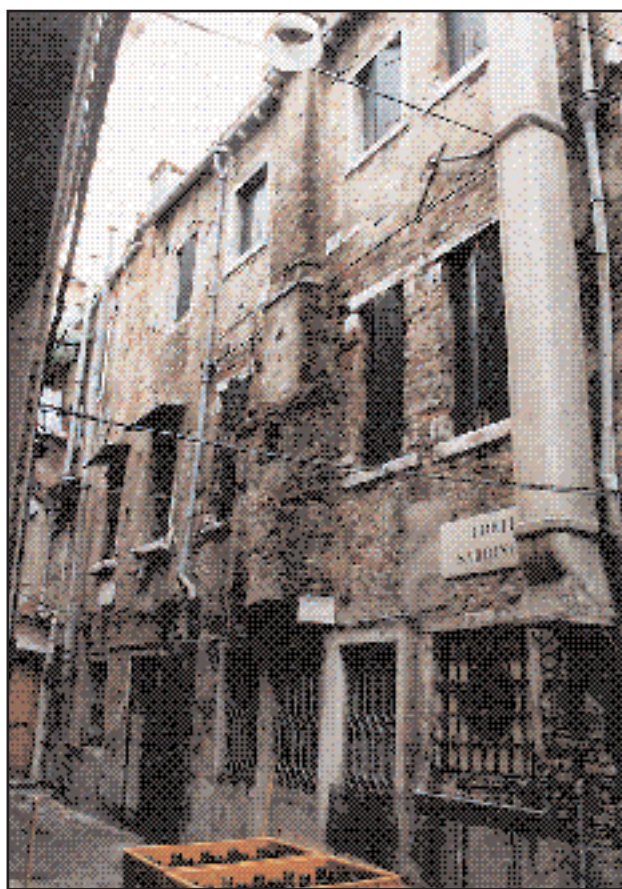
Μέτρια η κατάσταση του κτιρίου στην Corte Sarpionera. Η εξωτερική όψη του αποτελεί τον καλύτερο μάρτυρα για τις επισκευές που απαιτούνται.
