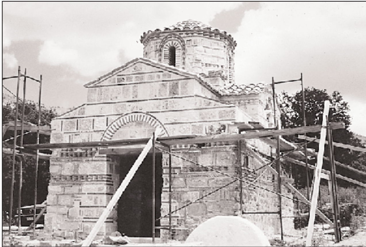
Στο Ρίβιο, ο ναός του Αγίου Στεφάνου, 13ος αιώνας. Το μνημείο κατά τη διάρκεια των αναστηλώσεων 1997-98.
