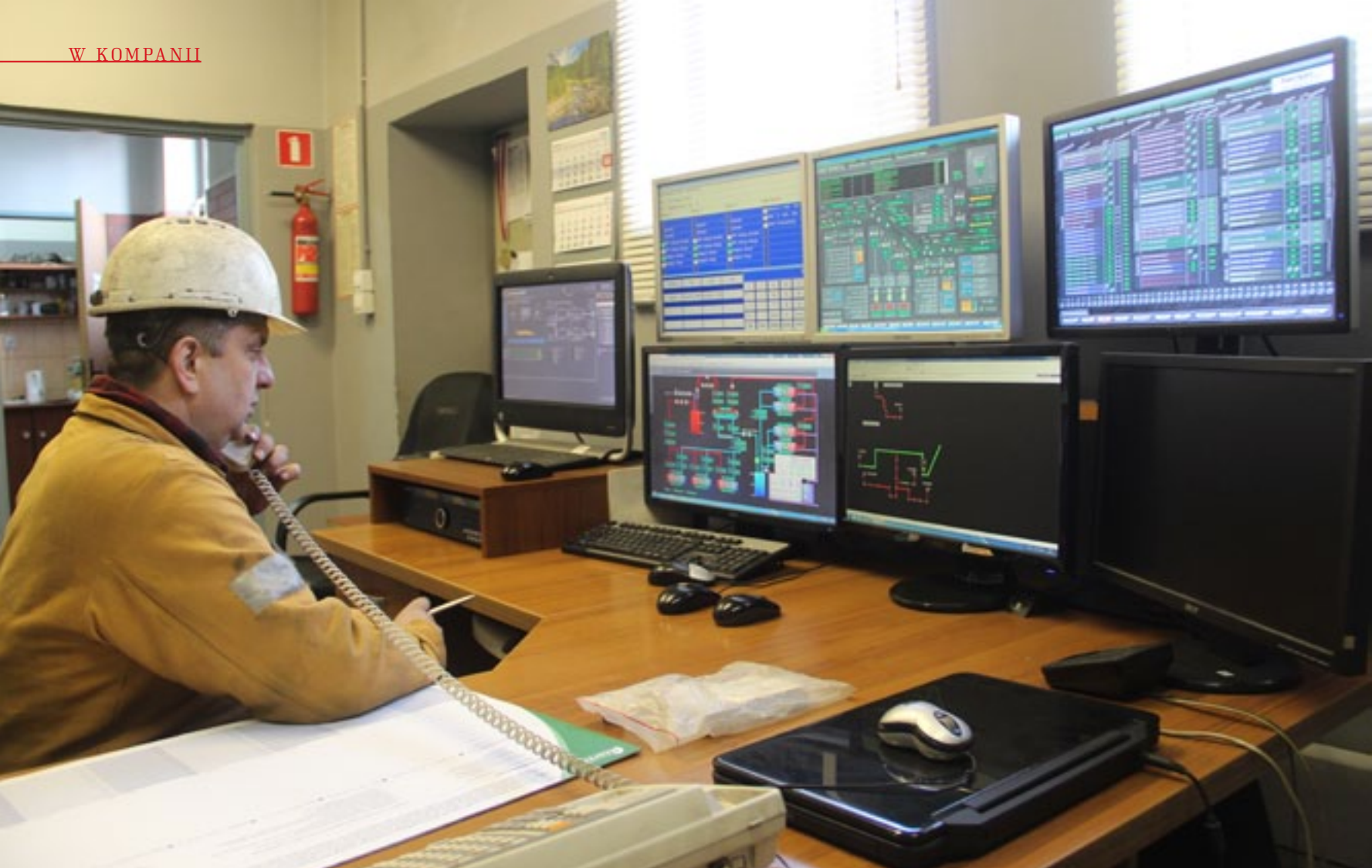
Pracę zespołu taśmociągów na bieżąco obserwują pracownicy dyspozytorni.
