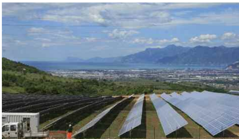
Eboli (SA), Parco Fotovoltaico in località Monti di Eboli: panoramica della valle del Sele
