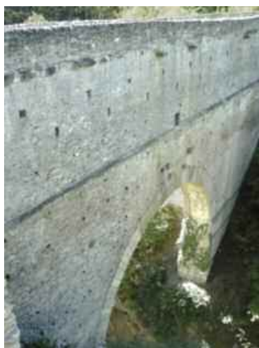
Veduta da nord-est dei due livelli sovrapposti del ponte acquedotto – foto S. Pinacoli
