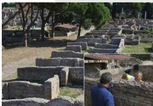
Fabbricato III XIV, 1. Protezione delle creste murarie che ripropone le caratteristiche di confezione e di tessitura dei nuclei murari.
