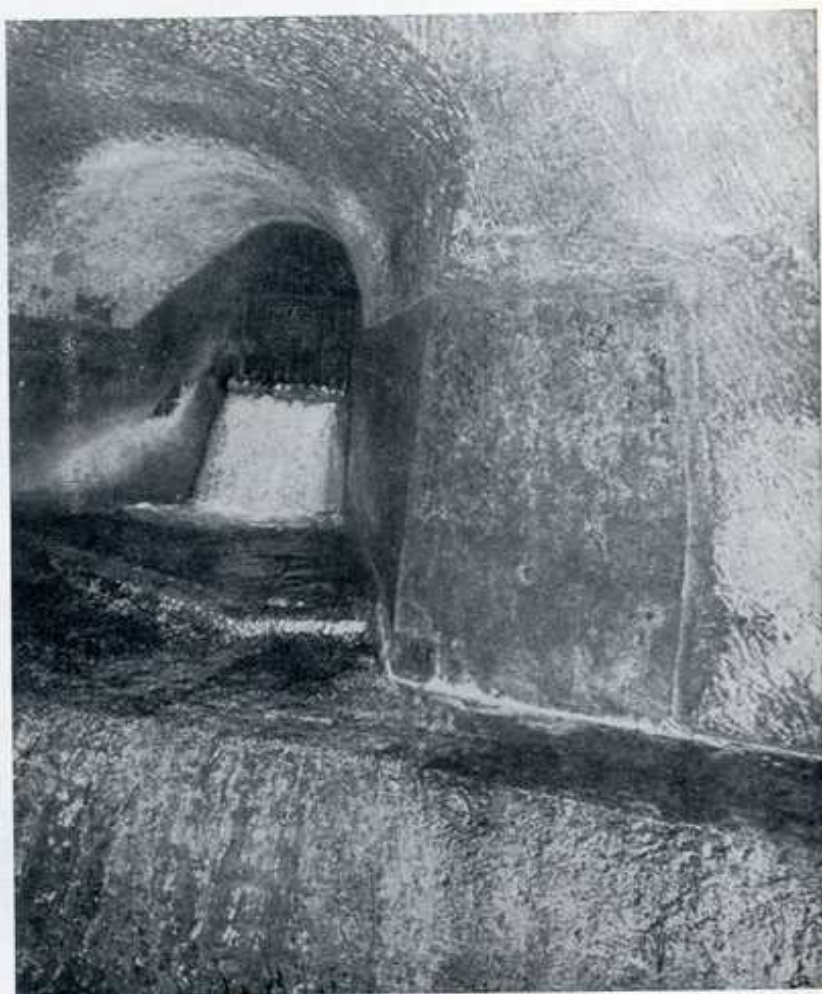
124 - Scarico di piena del serbatoio dell'Aquedotto a Capodimonte nel collettore orientale pluviale delle Colline.
