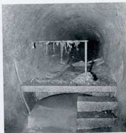
126 - Collettore medio: scarico all'impianto di Piedigrotta.
