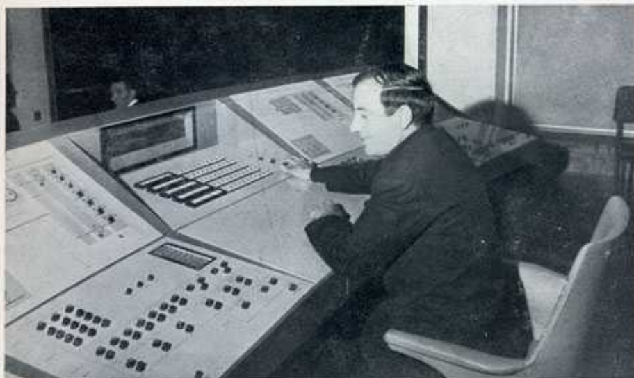
128-129-130-131 - Impianto elevatorio (Villa Comunale) delle acque nere e delle prime acque di pioggia della zona bassa occidentale; in fig. 128, banco elettronico di controllo esercizio per gli impianti elevatori di Mergellina, Villa Comunale, e Galleria della Vittoria; in fig. 129 sala-macchine; in fig. 130 vasca di aspirazione; in fig. 131 sala stacci rotanti.
