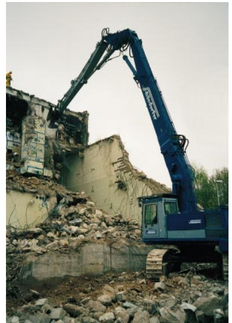
Abb. 21: Abbruch des Aufbereitungsgebäudes mit Hydraulikbagger (Langausleger) und Hydraulikzange – Der Mann auf dem Dach, der die Staubentwicklung mit dem Wasserschlauch mindern soll, ist angeseilt
