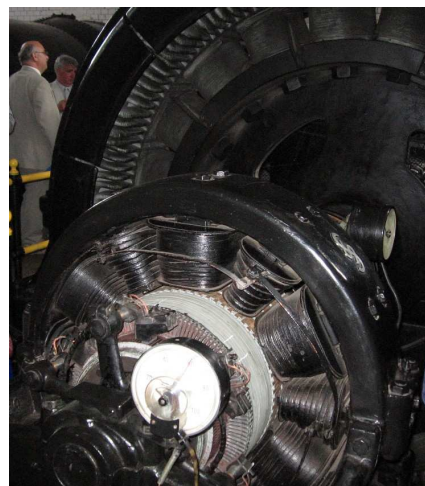
Fot. 2. Fragment maszyny w elektrowni Straszyn (fot. autora)
