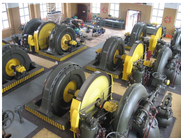
Fot. 4. Wnętrze budynku siłowni elektrowni w Gałąźni Małej (fot. autora)
