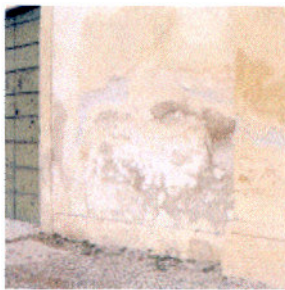
a) Parede a tratar
