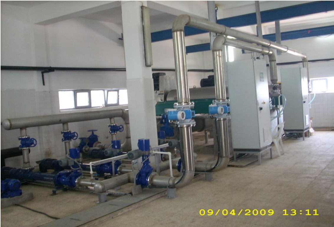
Şekil.D.17: Çamur Susuzlaştırma Ünitesi
