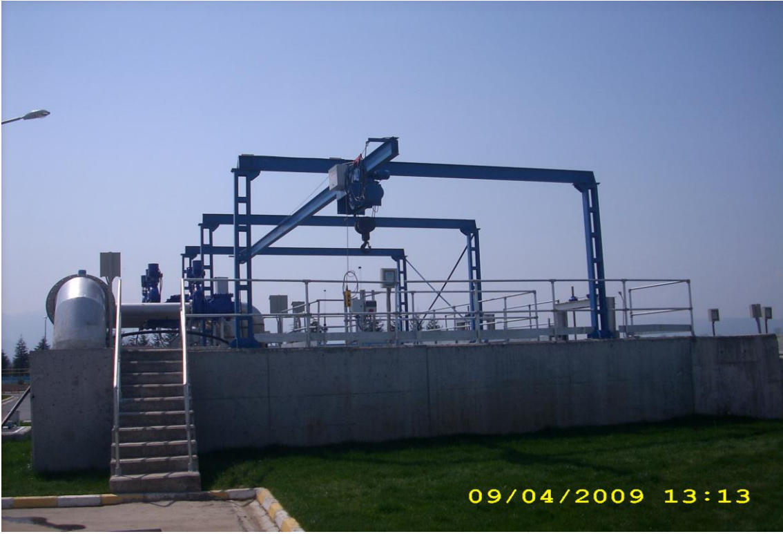
Şekil D.16: Geri Devir Fazla Çamur Pompa İstasyonu
