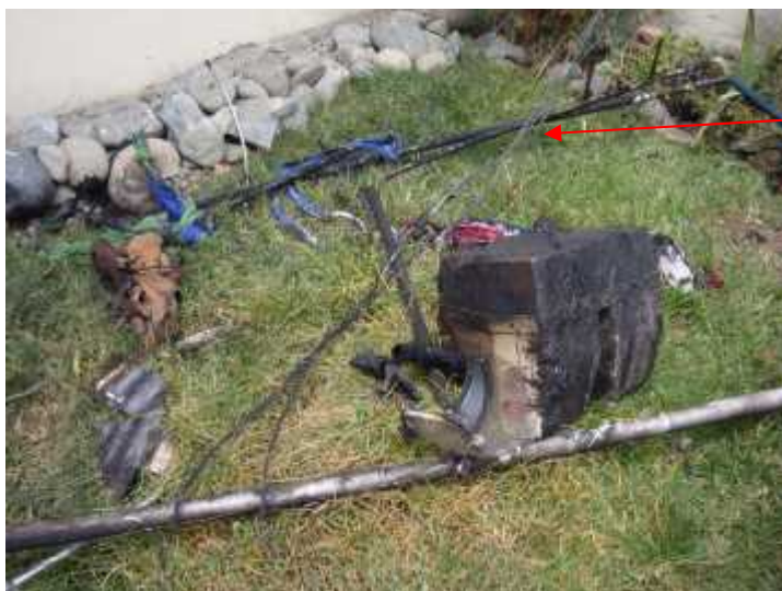
CABLES DE ENERGÍA ELECTRICA QUE ORIGINARON EL INCIDENTIO
