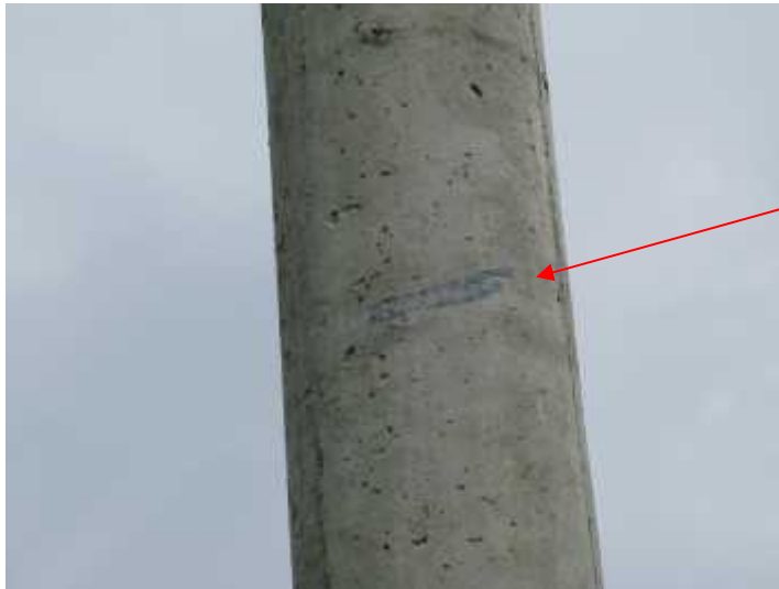
MARCA DEL IMPACTO DEL ALA DERECHA CONTRA EL POSTE DE ENERGÍA ELÉCTRICA
