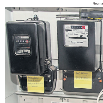
Für die alten mechanischen Stromzähler kommt das Aus.
