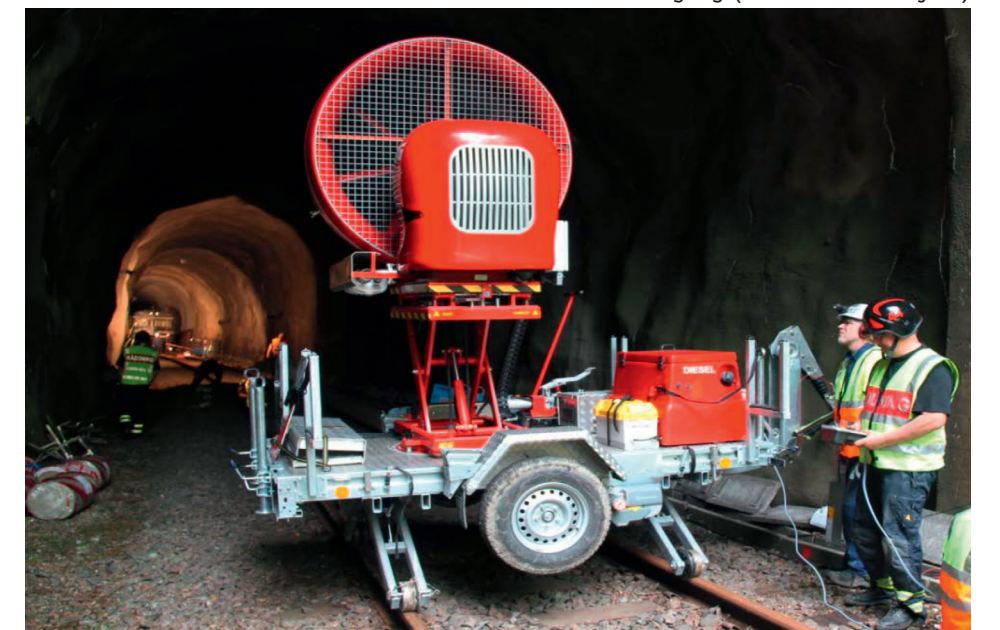
Abb. 5: Lüfter im Tunneleingang (Foto: METRO-Projekt)
