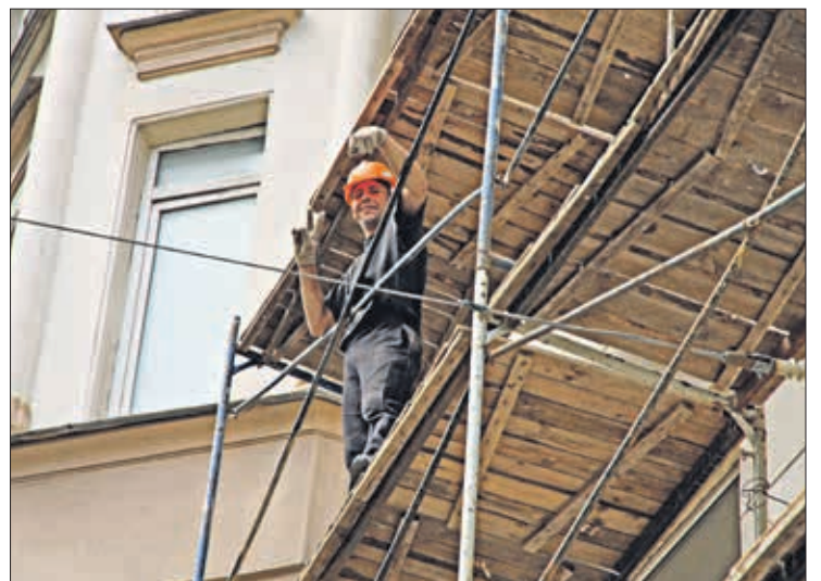
На Новопесчаной улице уже ставят строительные леса – здесь скоро начнется ремонт фасадов
