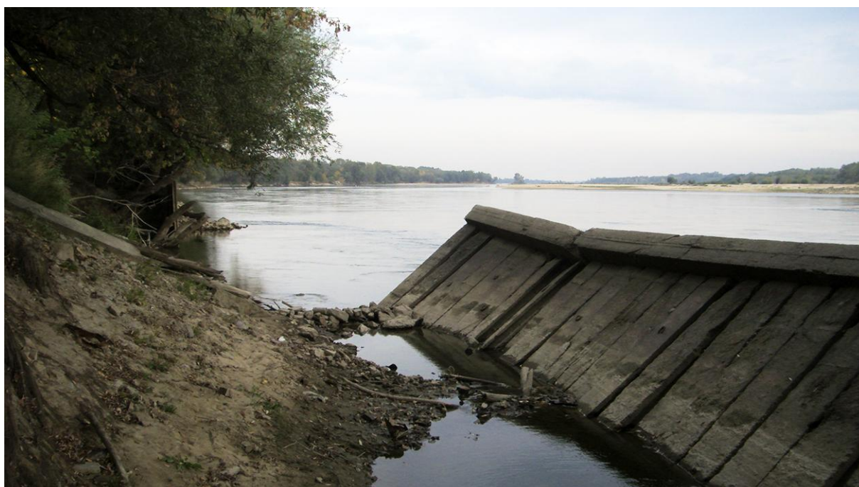
Fot. 87. Dewastacja brzegu prawego w wyniku postępującej erozji dennej i parcia naziomu. Po lewej stronie koryta widoczne odsypy piaszczyste i skraj łągów na terenie proponowanej lokalizacji
