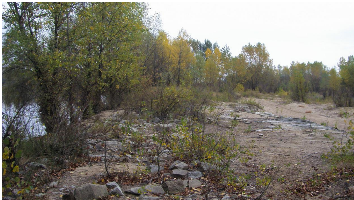
Fot. 88. Lewy brzeg Wisły w rejonie proponowanej lokalizacji. Widoczne odsłonięcie geowłkniny oraz ubytki narefulowanego piasku w wyniku oddziaływania wód powodziowych 2010
