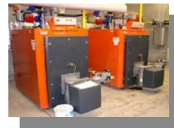
天然氣汽電共生(28kW)
