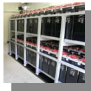
電池系統(100kW/h)
