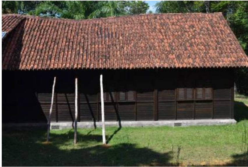
FIGURA 4.6.2-8 – Estrutura condenada do telhado do Centro de Visitantes interdito. Foto: Carlos Ferraz
