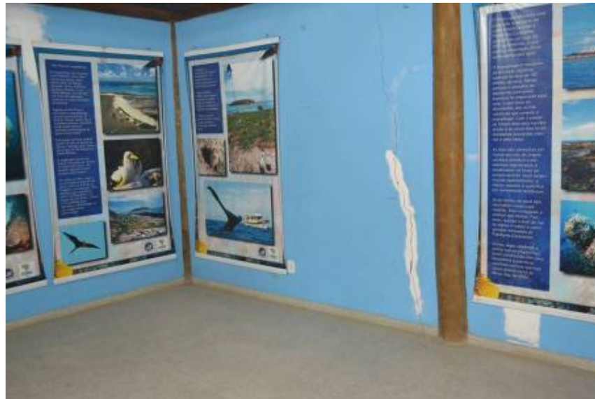
FIGURA 4.3.2-12 – Rachaduras na estrutura da sala de exposição. Foto: Carlos Ferraz.
