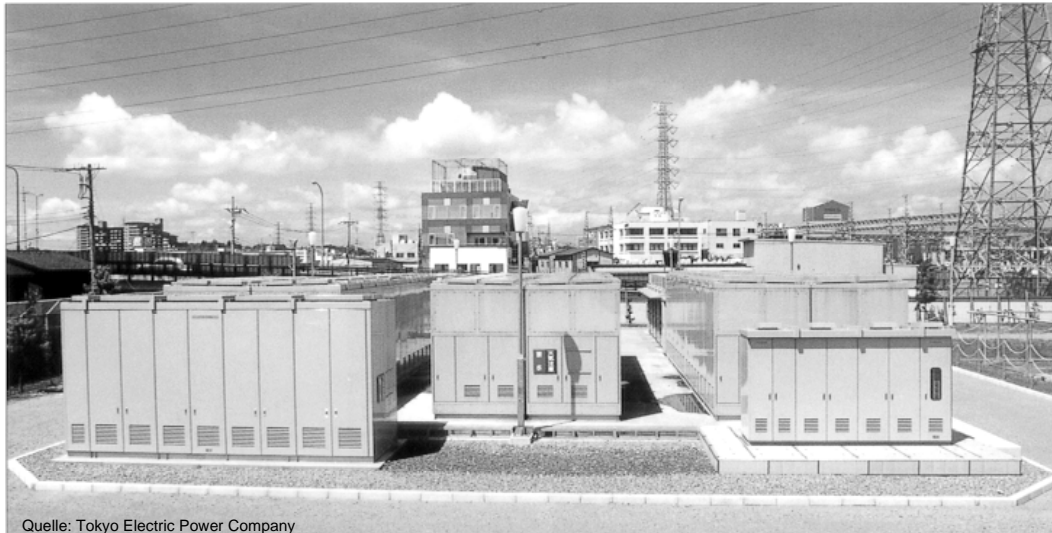
Abb. 11: Natrium-Schwefel-Hochtemperaturbatterie für den Load-Levelling-Betrieb (Tokyo Electric Power Company, Tsunashima - 6 MW, 48 MWh)
