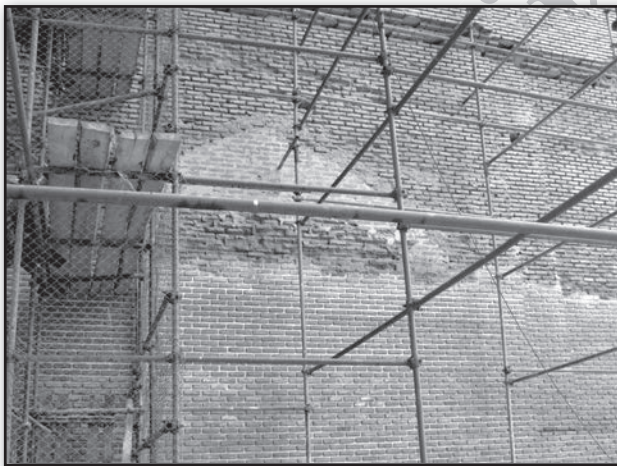
تصویر ۱۲. حذف واپسین نشانه‌های داغ طاق‌های ضربی سربازخانه عهد قاجاری از دیوار غربی ارک تبریز به وسیله آجرکاری‌های جدید و بر مبنای روش پاکسازی سبکی؛ مقایسه شود با تصویر ۱. تصویر در اردیبهشت ماه ۱۳۸۹ ه. ش تهیه شده است. مأخذ: آرشیو علی نعمتی بابایلو.
