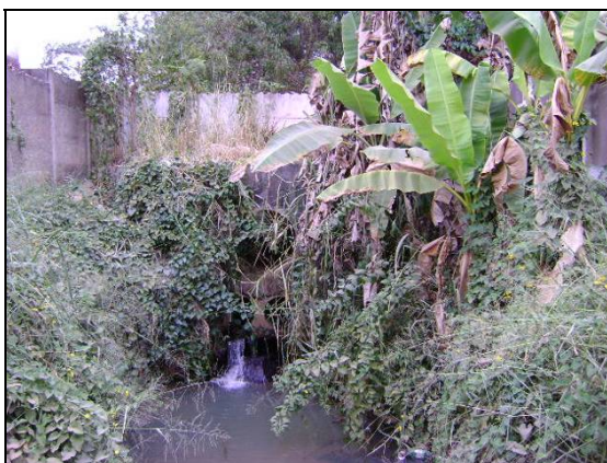
Foto 53 - Lançamento da rede interceptora em canal de drenagem aberto, sem tratamento do esgoto, junto à cidade.
