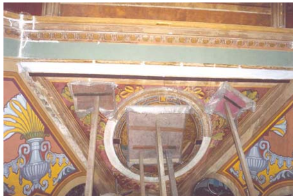
Fig.06: Escoramento dos painéis durante processo de instalação dos tirantes (cabos de aço e cintas).
