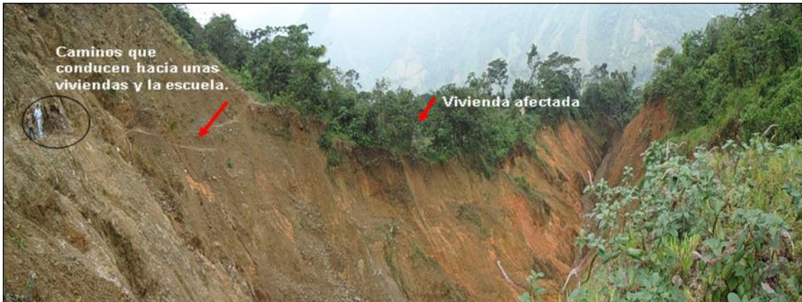
Imagen 6 Fenómeno de remoción en masa en la vereda Filo Real del municipio de Sardinata
