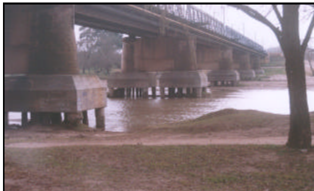
Figura1.- Descalce de pilas del Puente Carretero por descenso del cauce del Río Cuarto.
