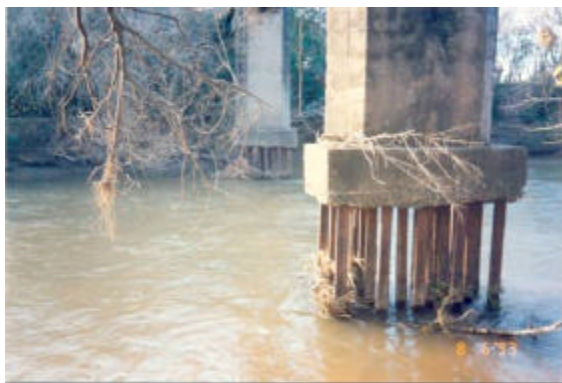
Figura 14.- Vista del destape de la fundación del Puente Ferroviario Tránsito sobre el Río Xanaes
