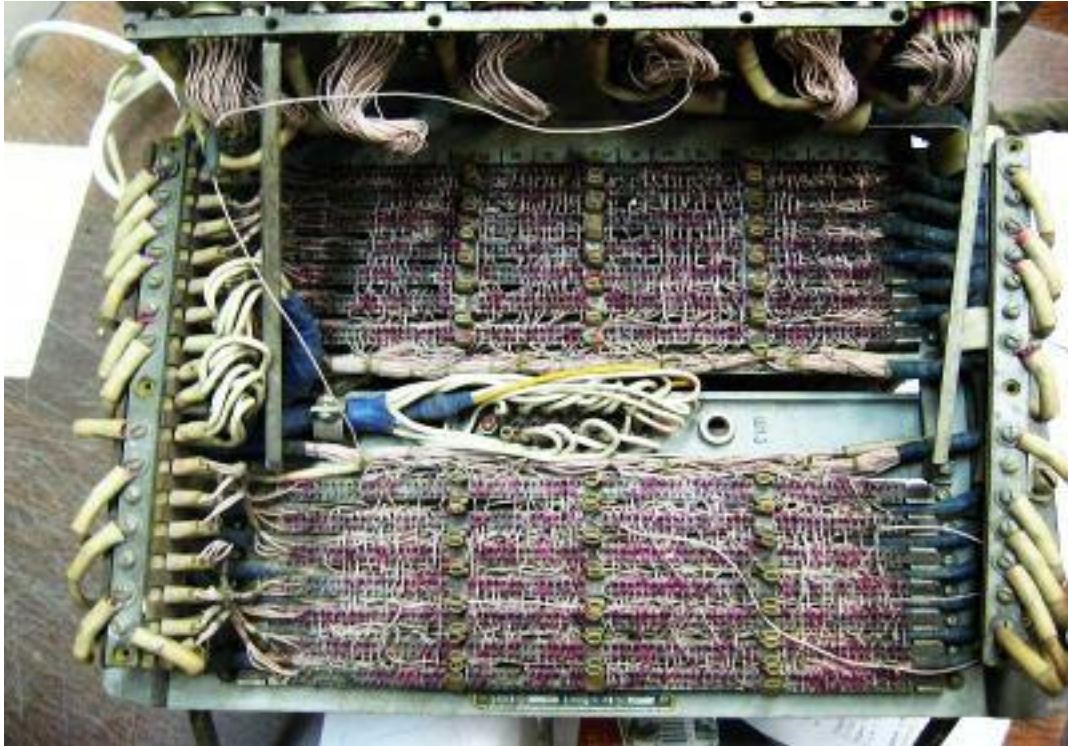
«Машинный» блок БНО со стороны монтажа
