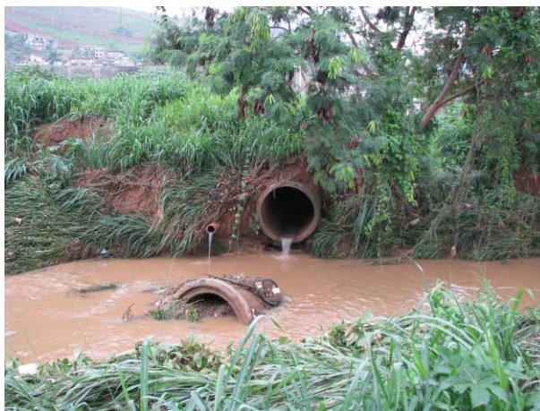
Figura 114 - Ponto de lançamento de esgoto no ribeirão Caladão em Coronel Fabriciano. Foto: Lume, 2008.
