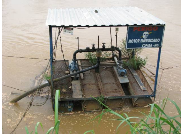
Figura 12 - Detalhe para a balsa de captação sobre água com aspecto impróprio para o consumo. Foto: Lume, 2008.
