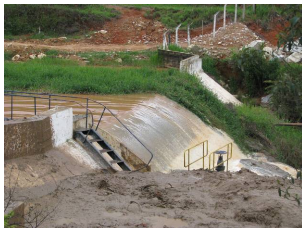
Figura 93 - Material retirado do barramento a fio d'água disposto de forma inadequada na margem direita do córrego. Foto: lume, 2008.
