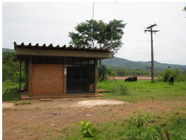
Figura 53 - Casa de força da bomba que envia a água para a ETA da COPASA. Foto: Lume, 2008.
