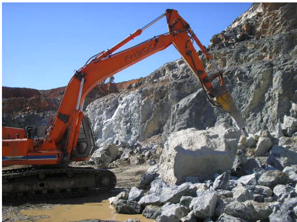
Figura 56 - Cava Joaspe em operação para extração de dunito. Foto: Pedreira Um Valemix, 2008.
