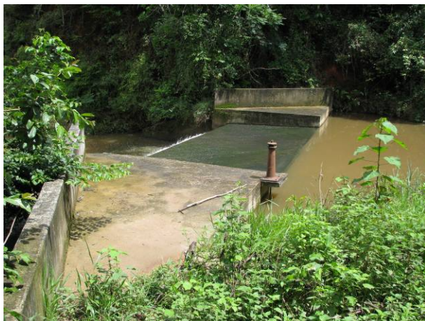
Figura 71 - Ponto de captação de água para a sede municipal de Bom Jesus do Amparo. Foto: Lume, 2008.
