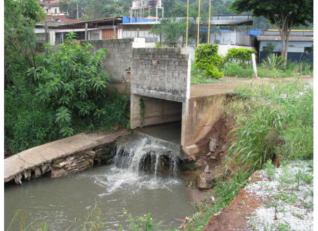
Figura 39 - Lançamento de esgoto da sede municipal no rio Santa Bárbara localizado no bairro Ferroviário. Foto: Lume, 2008.
