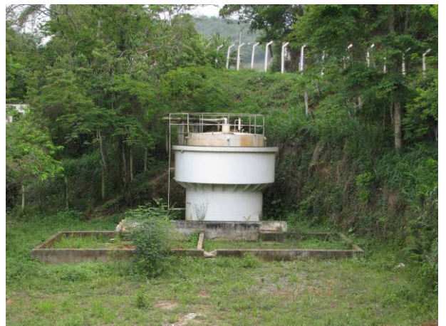
Figura 82 - ETE paralisada no distrito de Vargem Linda. Foto: Lume, 2008.
