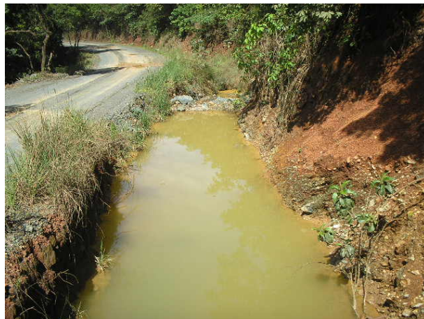
Figura 57 - Sump para acumulação de sedimentos de estrada. Foto: Pedreira Um Valemix, 2008.
