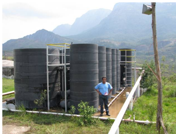
Figura 22 - Reservatórios de água tratada da ETA. Foto: Lume, 2008.
