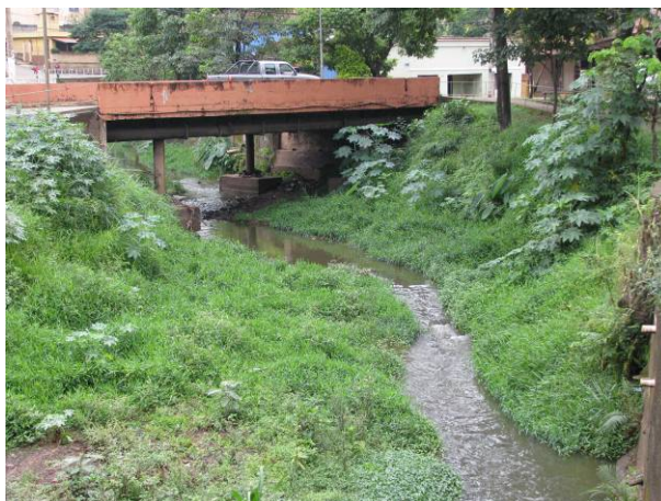
Figura 66 - Córrego São Miguel que recebe os efluentes gerados pelo bairro São Miguel. Foto: Lume, 2008.
