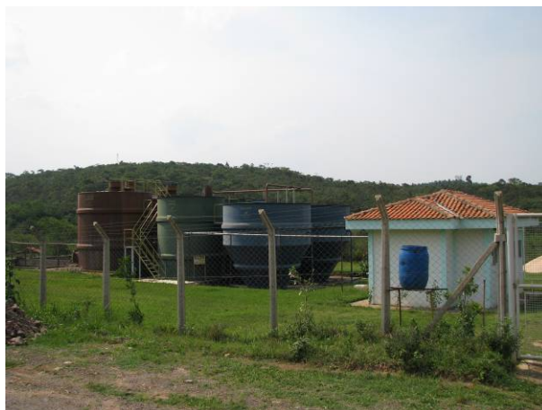
Figura 23 - Estação de Tratamento de Esgoto - ETE de Catas Altas, que processa 98% do esgoto da sede municipal.
