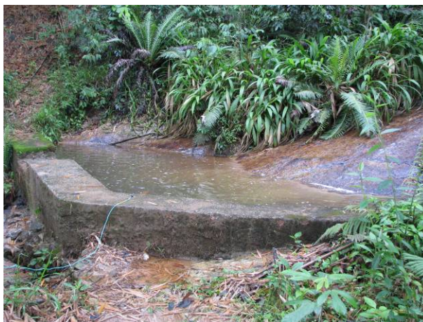
Figura 105 - Ponto de captação da sede municipal de Marliéria. Foto: Lume, 2008.
