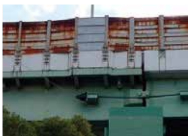
代表的なしゃ音壁の損傷（腐食）
