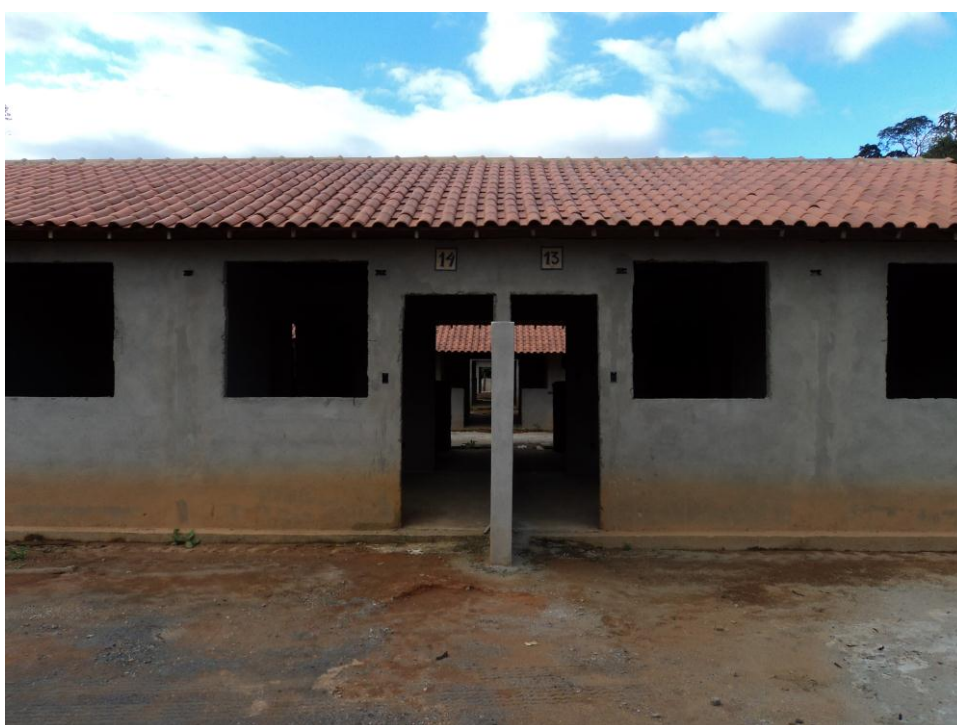
Figura 15: Habitações do Córrego do Caçador: Espessura da parede comum entre as residencias
