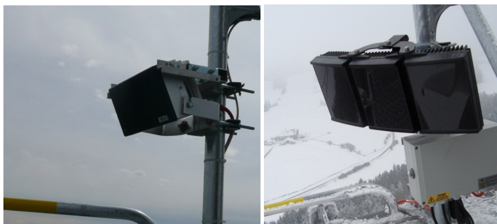
Abb. 4: Links: zuerst installierter IR-Scheinwerfer welcher sich als zu schwach erwies. Rechts: Später installierter stärkerer IR-Scheinwerfer.
