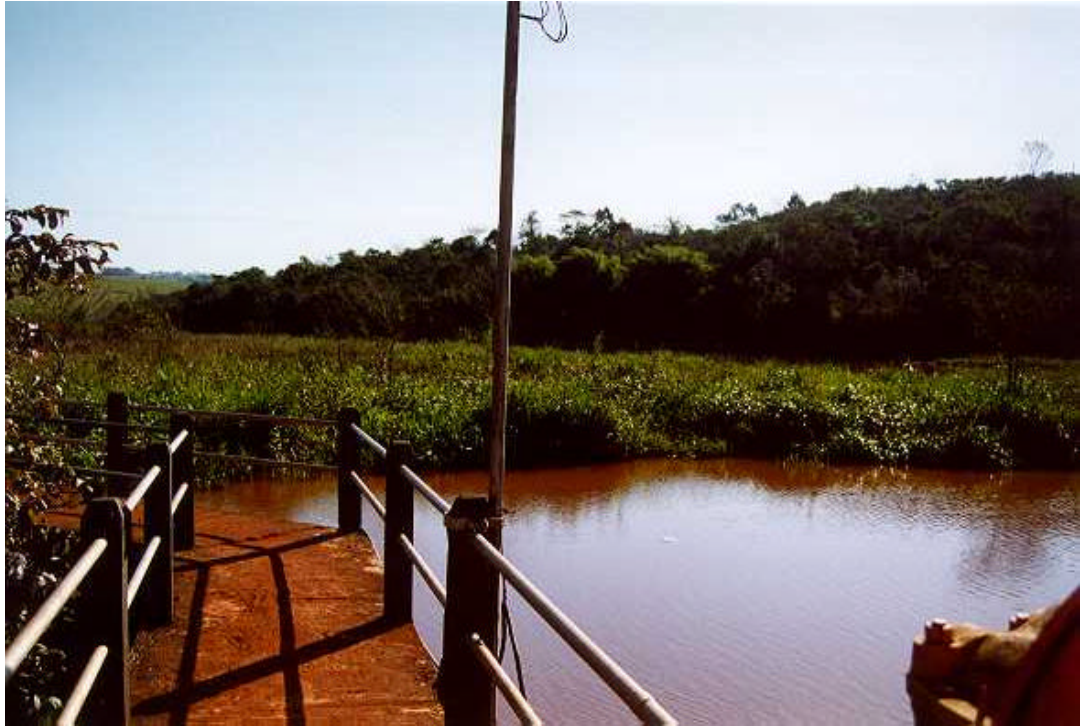
Assoreamento na margem direita próximo à Barragem
