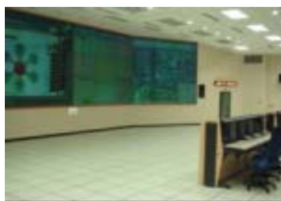
交通管理中心現況
