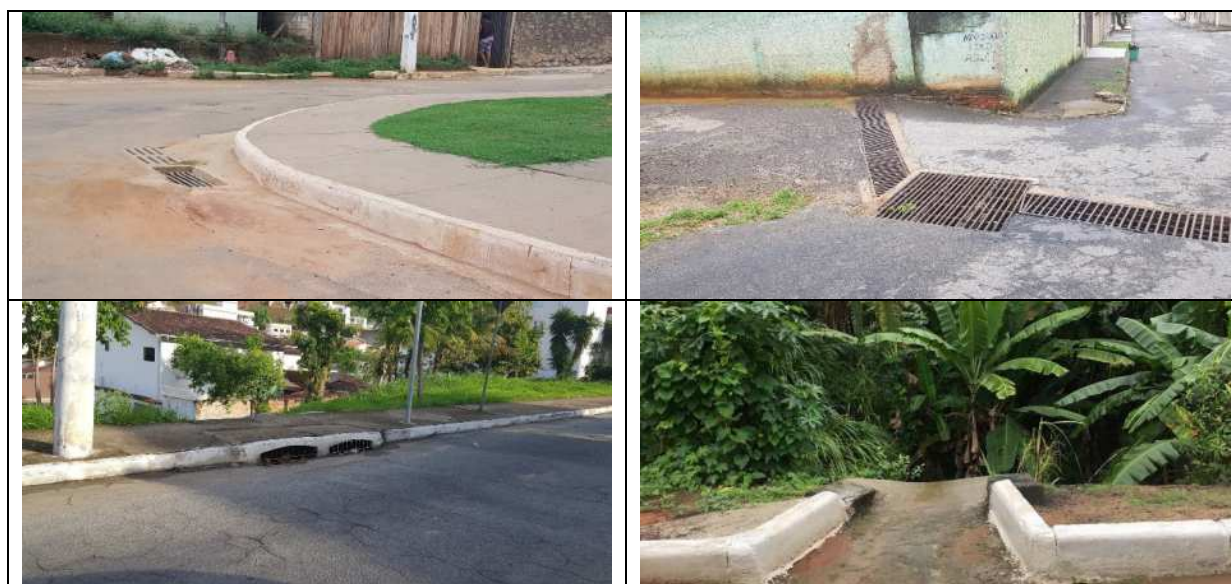
FIGURA 6.40: ESTRUTURAS DE MICRODRENAGEM EM ÁREAS URBANAS DE TIMÓTEO Fonte: ECOTÉCNICA-DETZEL, 2020.
