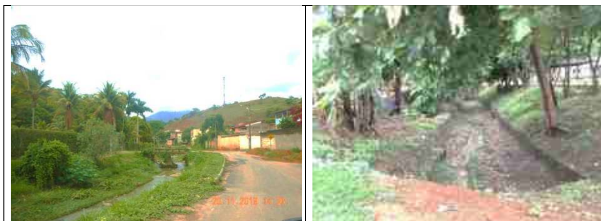
FIGURA 6.42: VISTAS DE ESTRUTURAS DE MACRODRENAGEM NECESSITANDO DE LIMPEZA NO MUNICÍPIO DE TIMÓTEO Fonte: ECOTÉCNICA-DETZEL, 2020.
