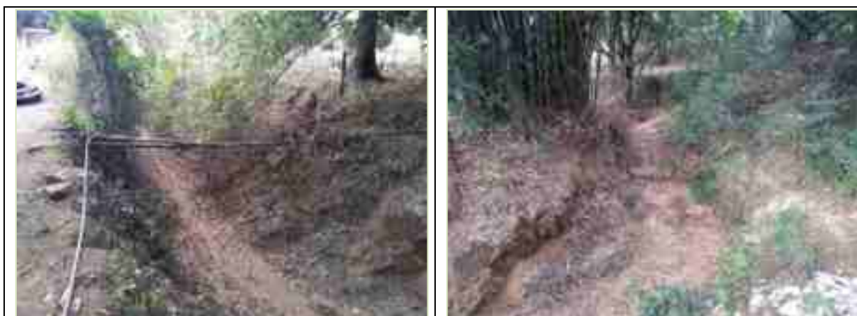
FIGURA 3.62: REGISTRO DE DRENAGENS SECAS. DETALHE PARA A FOTO ESQUERDA, QUE APARECE ENCANAMENTOS DE ÁGUA. COORDENADAS UTM 23S 751.634 E 7.837.817. Fonte: Detzel et al., 2020.
