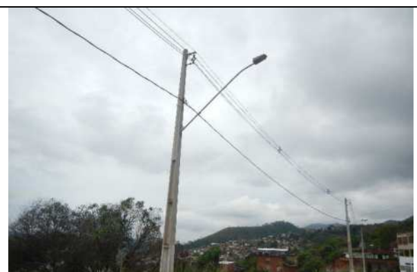
FIGURA 6.48: VISTA DE POSTE AÉREO DE ENERGIA E ILUMINAÇÃO PÚBLICA Fonte: ECOTÉCNICA-DETZEL, 2019
