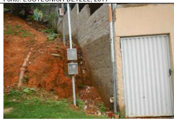
FIGURA 6.50: VISTA DE CAIXA DE DISTRIBUIÇÃO DE ENERGIA ELÉTRICA Fonte: ECOTÉCNICA-DETZEL, 2019
