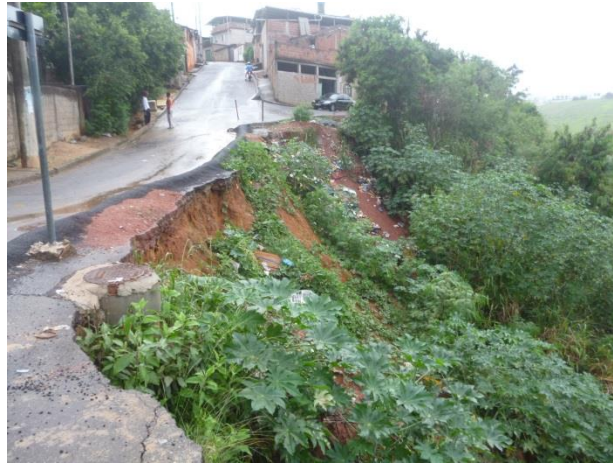
Foto 5.100 – Erosão próxima a casas, comprometendo já parte da rua (Bairro Vale do Sol)
