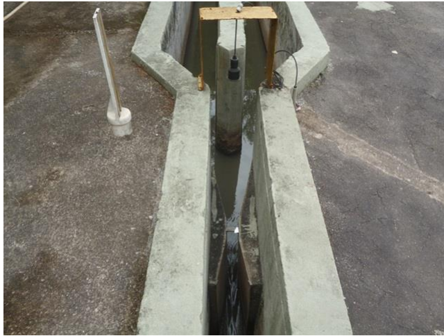
Foto 5.40 – ETE Areal – Calha Parshall
