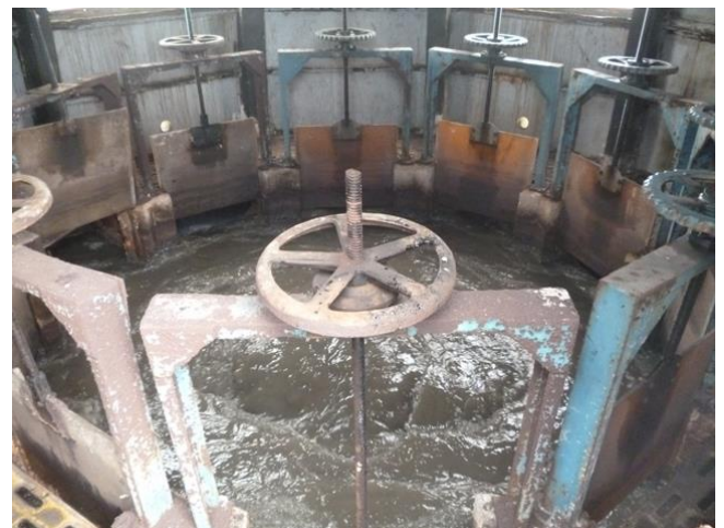
Foto 5.33 – ETE Ipanema – EEE02 – Caixa de Distribuição de Vazão
