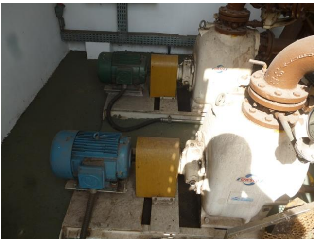
Foto 5.42 – ETE Horto – Elevatória de Esgoto
