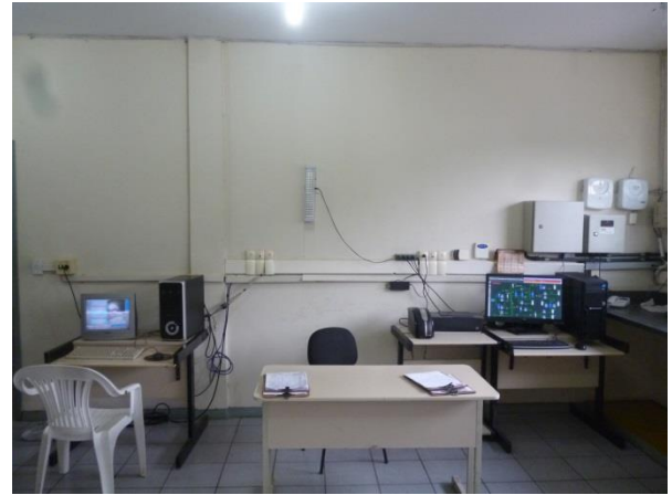
Foto 5.10 – ETA Amaro Lanari – Sistema de Automação
