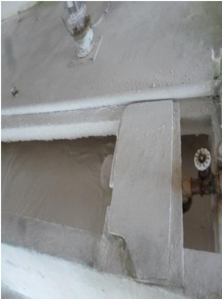
Foto 5.3 – Tanque de adição de cal
