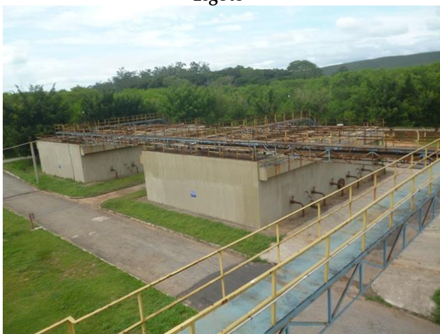
Foto 5.34 – ETE Ipanema – Reatores UASB
