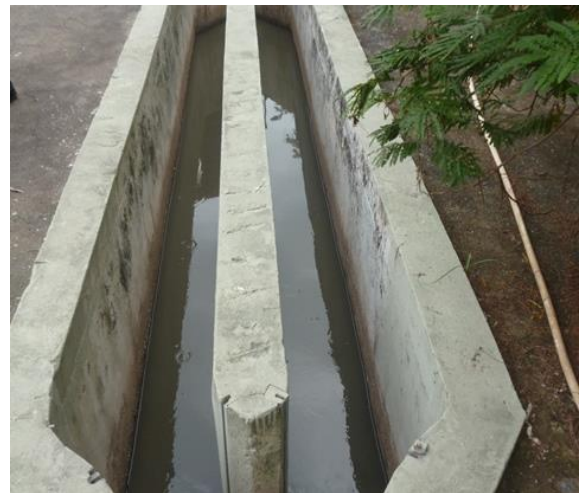
Foto 5.39 – ETE Areal – Desarenador
