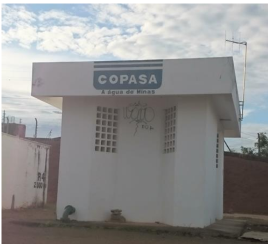
Foto 5.20 – EAAB RSE-04 – Casa de Bombas
