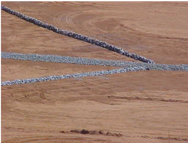
Foto 5.68 – Drenos de lixiviados
