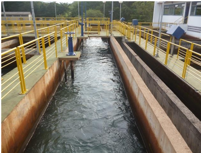
Foto 5.5 – ETA Amaro Lanari– Tanque de Divisão da Água para os Tanques de Tratamento
