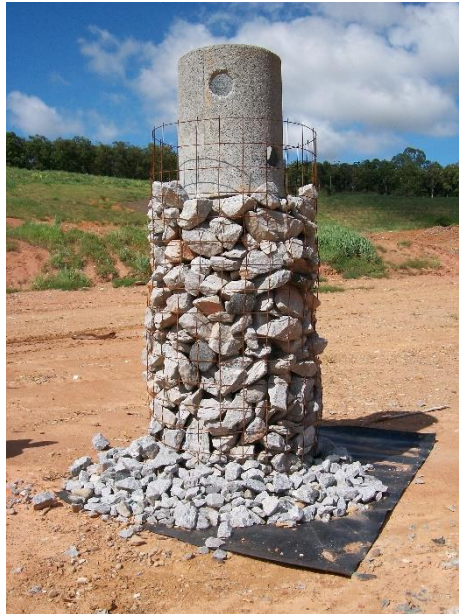
Foto 5.71 – Dreno de biogás do aterro sanitário
