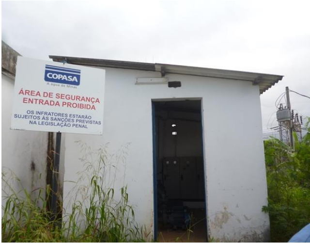
Foto 5.16 – EAAB RSE-02 – Casa de Bombas
