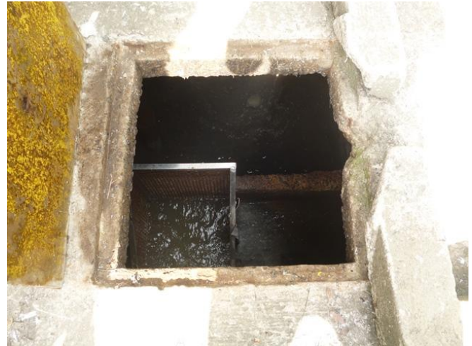
Foto 5.41 – ETE Horto – Poço de Sucção da EEE
