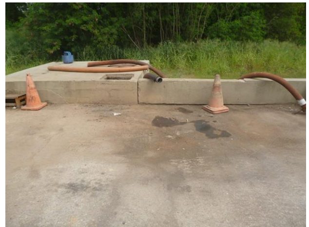
Foto 5.27 – ETE Ipanema – Caixa de Chegada/Reunião do Esgoto Coletado
