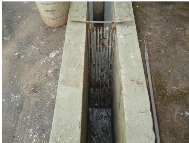
Foto 5.38 – ETE Areal – Chegada do Esgoto e Gradeamento
