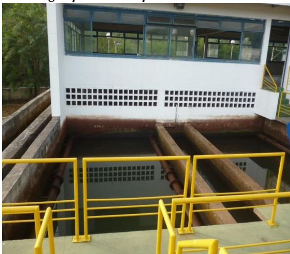
Foto 5.7 – ETA Amaro Lanari – Filtros
