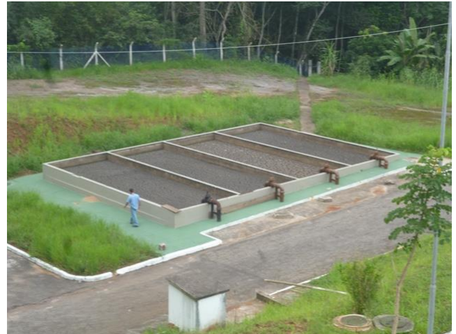
Foto 5.47 – ETE Bela Vista – Leito de Secagem do Lodo
