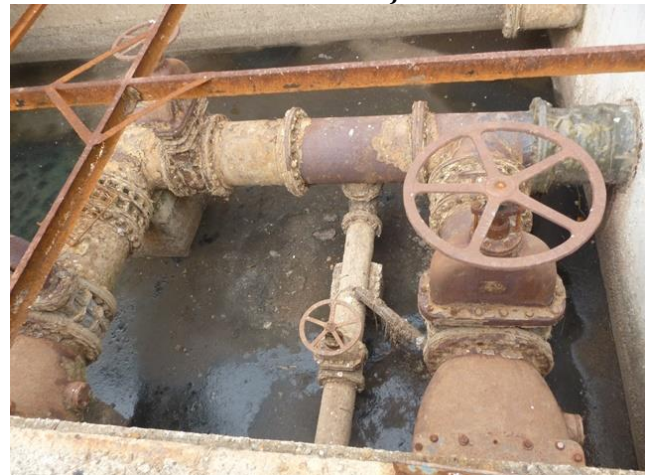
Foto 5.25 – EEE Vila Ipanema – Conjunto Motobomba
