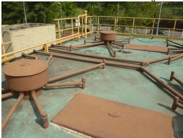
Foto 5.44 – ETE Horto – Reator UASB
