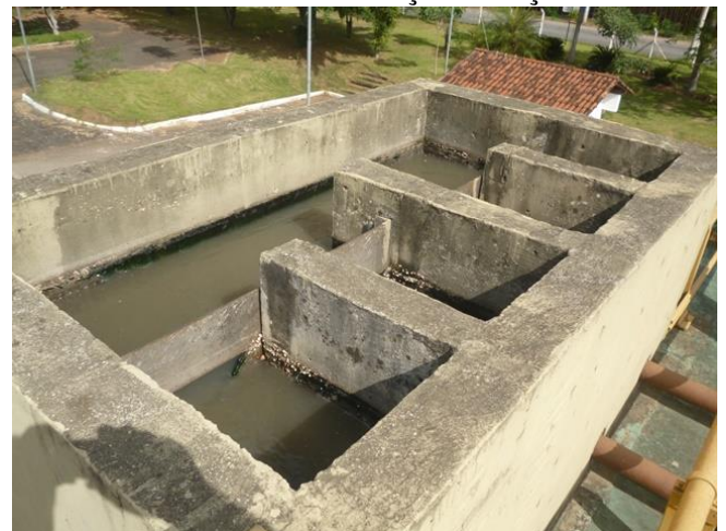
Foto 5.43 – ETE Horto – Caixa de Distribuição de Vazão
