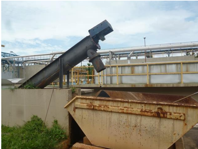
Foto 5.30 – ETE Ipanema – Remoção de Areia
