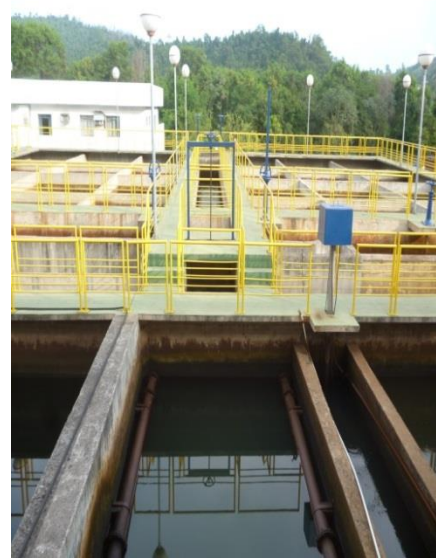
Foto 5.6 – ETA Amaro Lanari– Vista Geral dos Tanques de Tratamento
