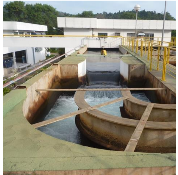
Foto 5.4 – ETA Amaro Lanari – Chegada da Água Bruta – Calha Parshall e Redutor de Velocidade
