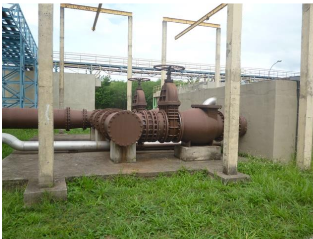
Foto 5.32 – ETE Ipanema – Estação Elevatória de Esgoto
