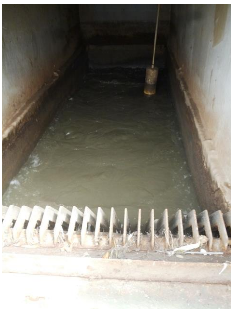
Foto 5.28 – ETE Ipanema – Gradeamento Grosso
