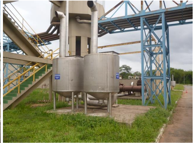
Foto 5.31 – ETE Ipanema – Filtro de Ar de Carvão Ativado
