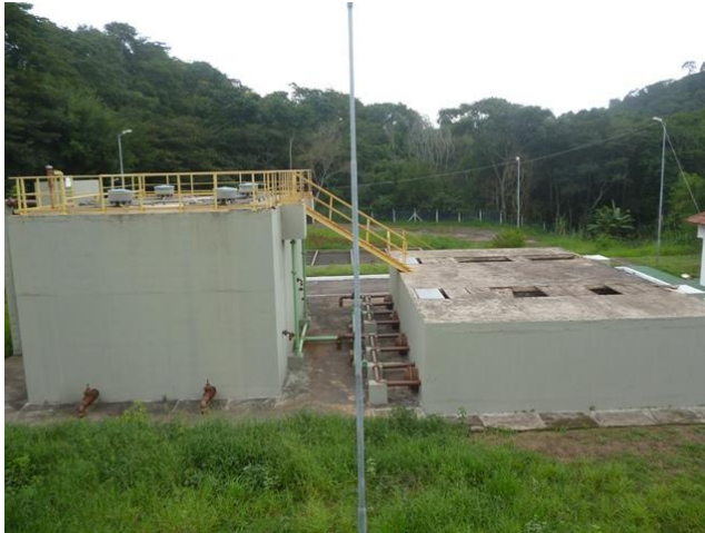
Foto 5.46 – ETE Bela Vista – UASB + Filtro Biológico
