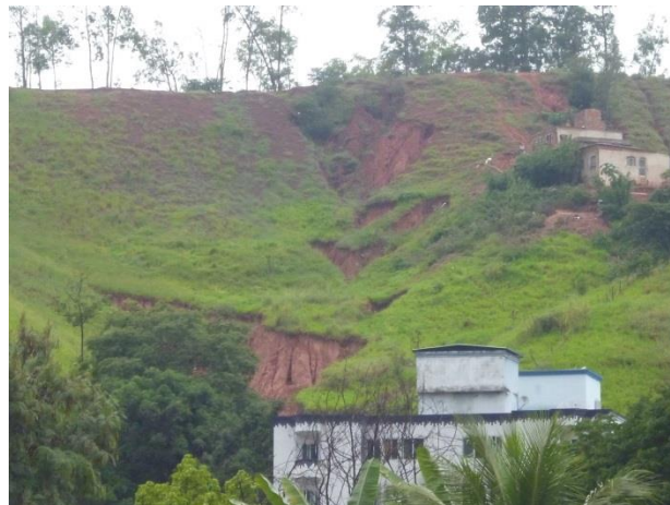
Foto 5.99 – Erosão próxima a casas (Bairro Vagalume)
