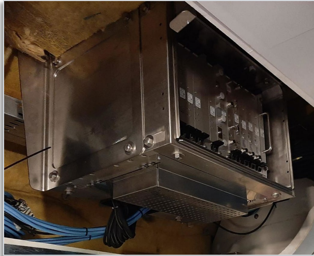
Im Deckenbereich montierter ETCS-Fahrzeugrechner (EVC)
