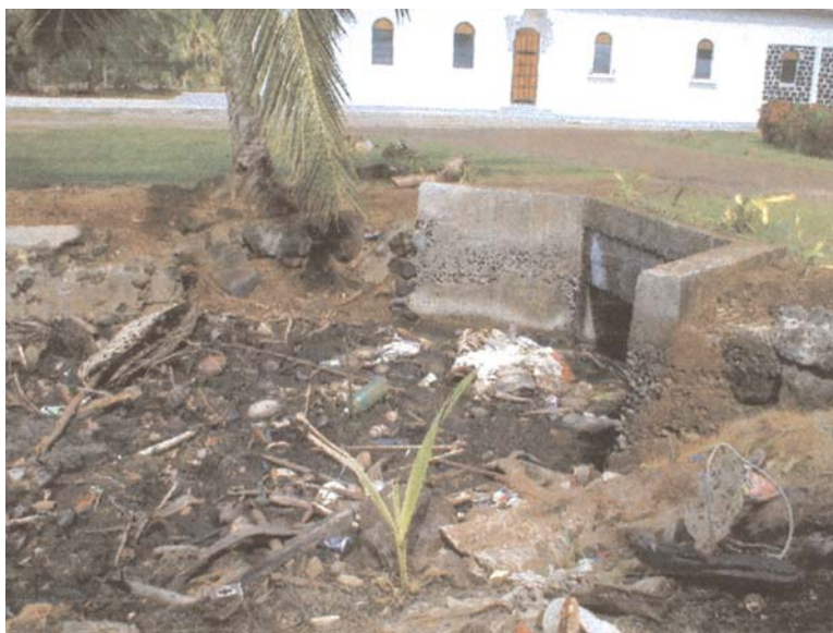
Figure 5 Exutoire d'eaux usées à Falaleu.
