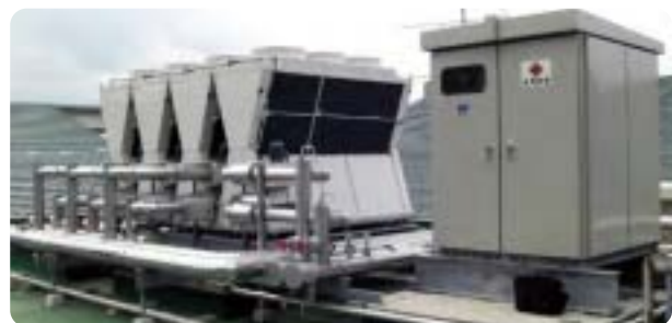
電気式ヒートポンプ空調
